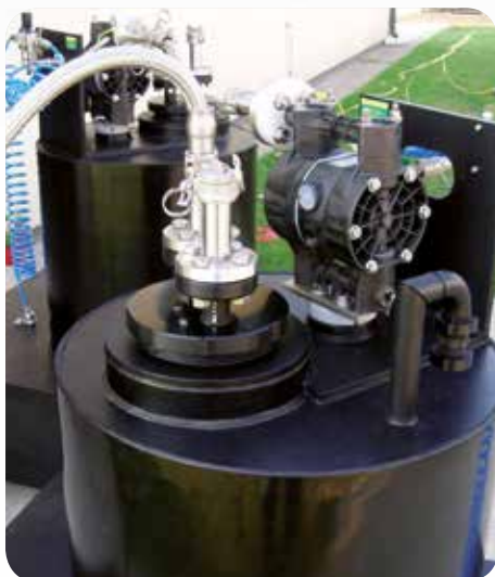
Sósav szállítása ATEX környezetben
