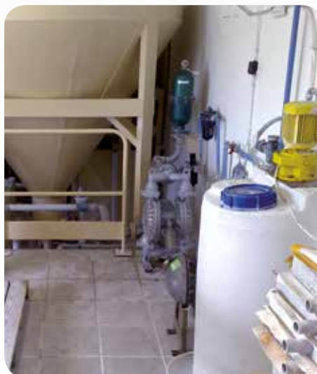
Porcelángyár- szennyvíziszap víztelenítés
