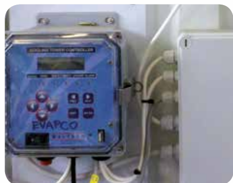
Ásványvíz üzem hűtőtorony-WCT műszer
