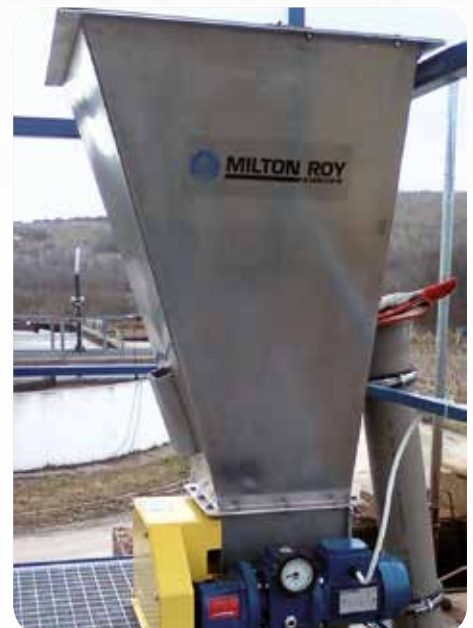
Vízmű- mészhidrát adagolás
