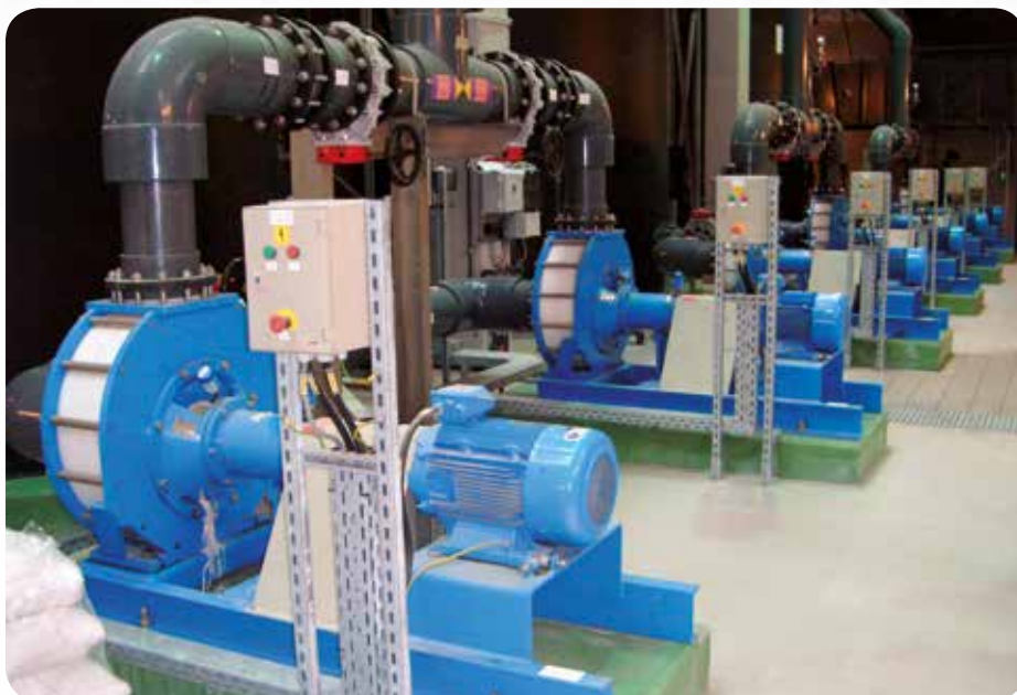
Szennyvíztisztító telep- bűztelenítés
