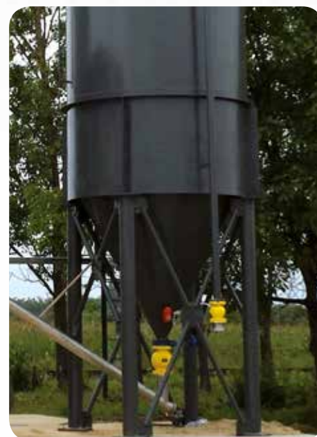
Mészhidrát siló ürtése
