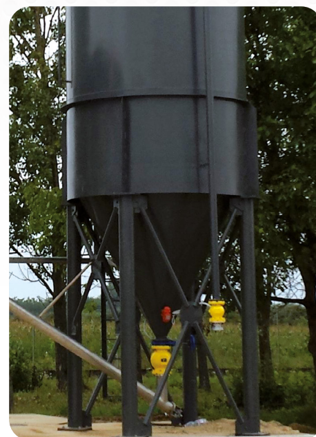
Mészhidrát siló ürtése
