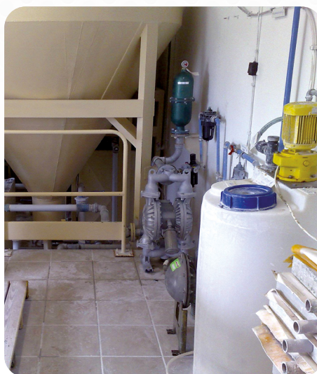
Porcelángyár- szennyvíziszap víztelenítés
