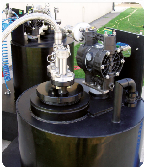
Sósav szállítása ATEX környezetben
