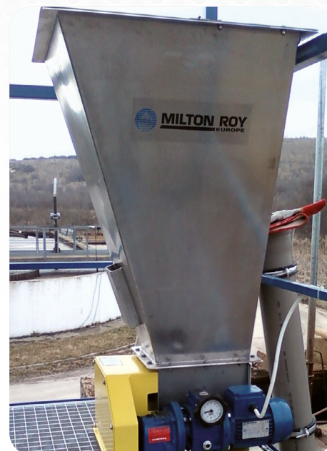
Vízmű- mészhidrát adagolás
