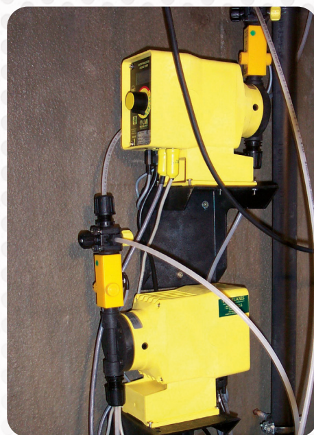
Uzodai vízkezelés-hidrogén-peroxid adagolása
